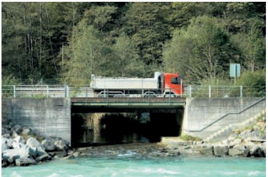
Blick von der Reuss-Seite: Bachdurchlass Bielenhof vor der Sanierung: Mit 9 m Breite und einer Höhe von rund 2,5 m ist der Durchlass für grössere Wildtiere nicht geeignet.
