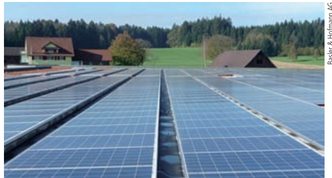
Bild 4 Teilansicht auf das Flachdach der Solaranlage Pistor-Edisun Power.
