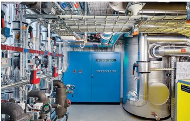
5 Die Energiezentrale für beide Gebäudeteile. Foto: René Dürr
