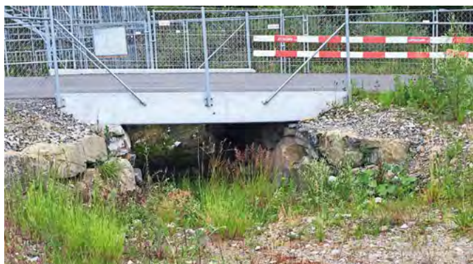
5 | Kleintierunterführung zur Vernetzung Bahnböschung mit Reusszopf-Aue. 5 | Tunnel pour petits animaux pour relier le talus de chemin de fer au Reusszopf-Aue.
