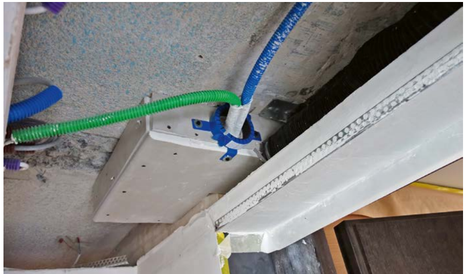
Abb. 2: Der Brandschutzabschluss wurde durch die Durchführung von Leerrohren geschwächt. Mit zertifizierten Produkten wurde eine Eigenkonstruktion erstellt, deren Wirksamkeit in diesem Massstab aber keineswegs sichergestellt ist.
