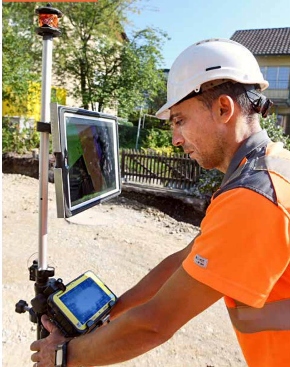
Der Polier von Walo nimmt laufend die Punkte auf, die für die dreidimensionale Modellierung der ausgeführten Infrastrukturbauten, den sogenannten digitalen Zwilling, benötigt werden.
