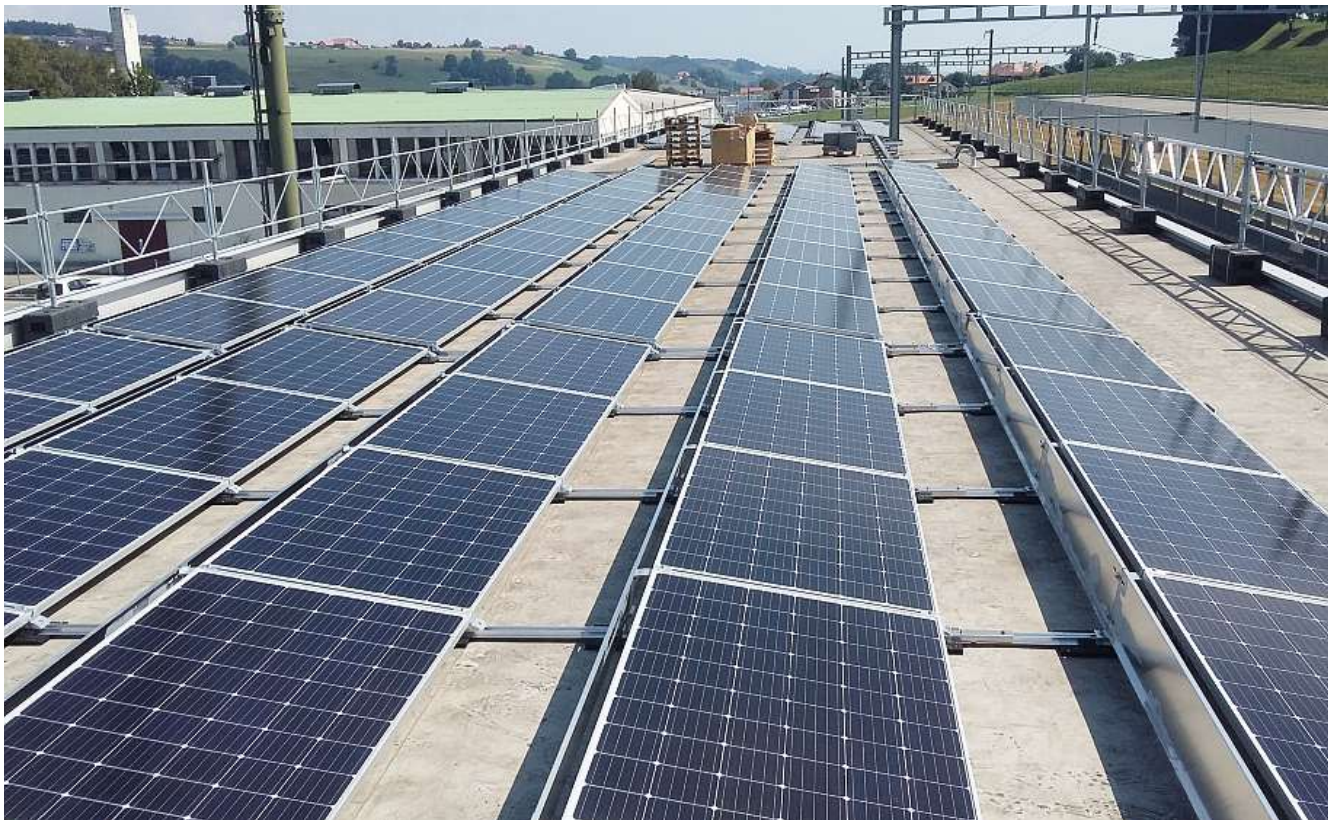
In Zusammenarbeit mit einem Contractor haben die Freiburgischen Verkehrsbetriebe (TPF) an bisher vier Standorten (im Bild der Bahnhof Belfaux) PV-Anlagen auf Perron-Dächern realisiert. Die Grösse der PV-Anlage wird auf das Eigenverbrauchspotenzial des jeweiligen Bahnhofs abgestimmt. Zirka 60 % des produzierten Stroms können direkt vor Ort verbraucht werden (Sicherheitseinrichtungen, Werbung, Billett-Automaten, Belüftungen).
