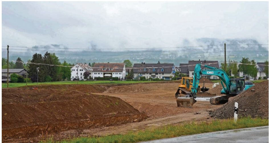
Mit Baumaschinen wird das Gelände an der Verbindungsstrasse zwischen Riedikon und Nossikon grossflächig abgetragen. Foto: Martin Mächler
